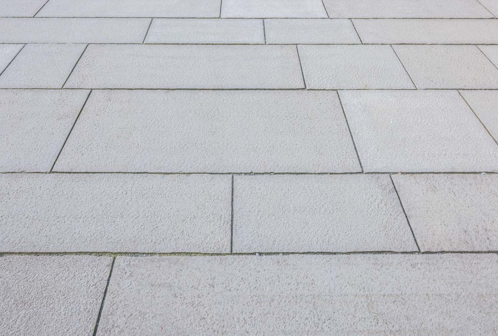
Bodenbelag, Bodenplatten geschurt, Pfisterschüür, Thalwil
