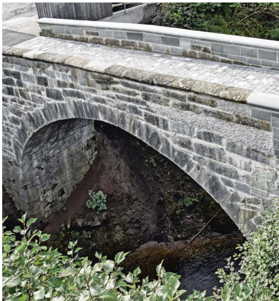
Das historische Feeling beim Überqueren der Brücke ist wieder perfekt, was auch der traditionellen Pflasterung zu verdanken ist.
